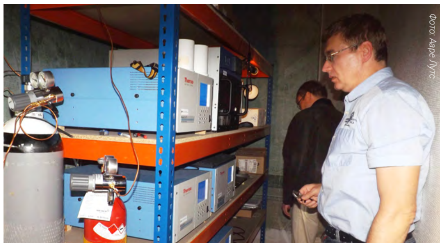
■ Анализаторы загрязняющих газов измеряют воздух на станции Тахкузе
